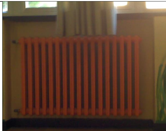
Figura 4.7 – Rilievo termografico dei radiatori
