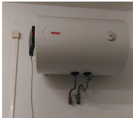
Figura 4.12 - Particolare di un boiler elettrico per la produzione di acqua calda sanitaria
