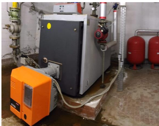
Figura 4.11 - Particolare della Caldaia
